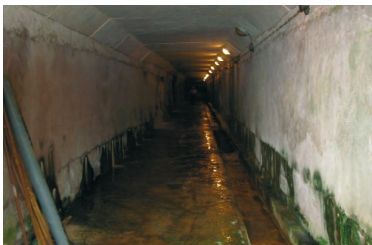
Рисунок 5.3 – Фильтрация воды в потернах бетонной плотины
