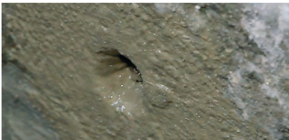
Рисунок 7.2.40 – Поверхность бетона после заполнения полости течи смесью «Ватерплаг» или «Пенеплаг» и обработки растворной смесью «Пенетрон»
