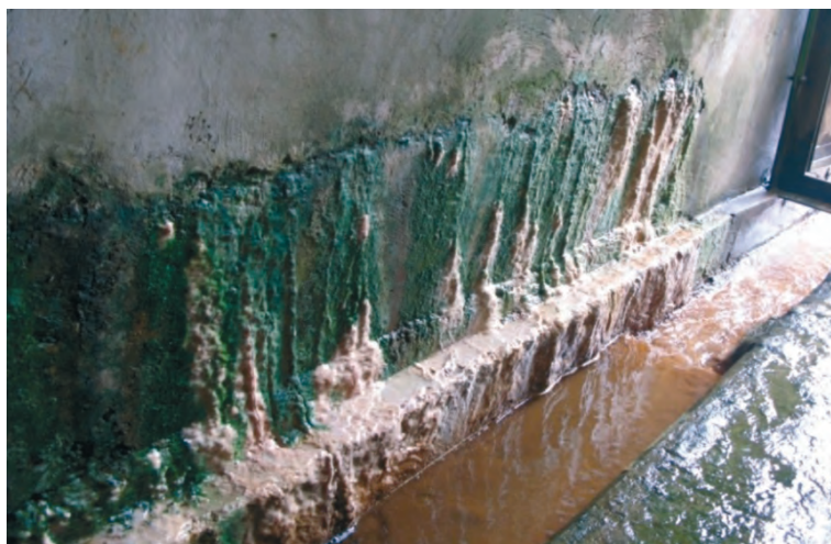
Рисунок 5.4 – Фильтрация воды через горизонтальные стыки бетонирования в потерне бетонной плотины
