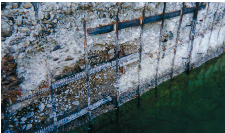
Рисунок 7.4.1 – Участок разрушенного бетона в зоне переменного уровня воды
