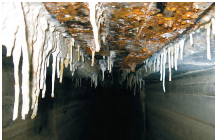
Рисунок 5.1 – Фильтрация воды через потолочное уплотнение деформационного шва с выносом гидроксида кальция и образованием «сталактитов» в соединительной галерее здания ГЭС
