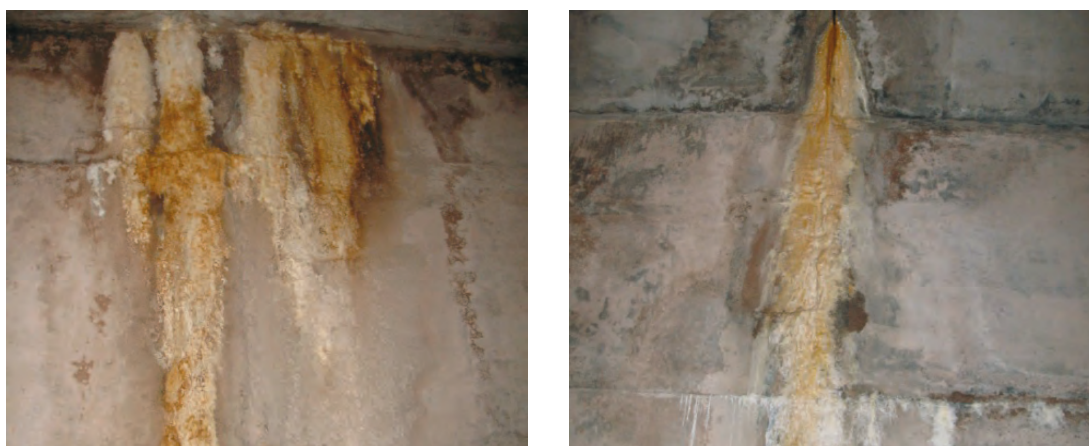
Рисунок 6.7.2 – Транспортно-кабельный туннель: а – выходной оголовок туннеля; б – фильтрация воды через стены туннеля с выносом свободной извести и продуктов коррозии арматуры
