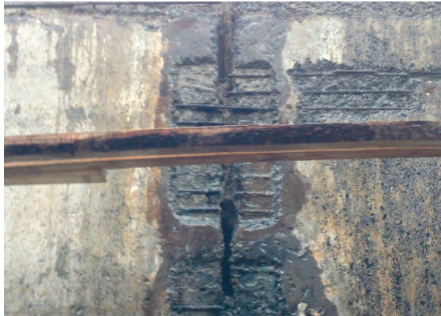
Рисунок 7.4.4 – Состояние арматуры в конструкциях
