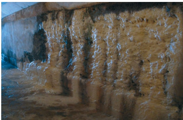
Рисунок 5.5 – Фильтрация воды по «рабочему шву» бетонирования между стеной и перекрытием потерны
