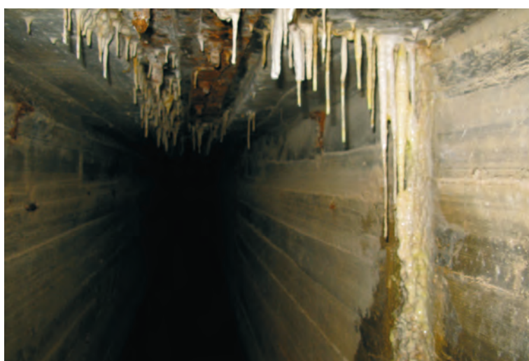
Рисунок 5.2 – Фильтрация воды с выносом гидроксида кальция через стыки бетонирования и из-под потолочного уплотнения деформационного шва в соединительной галерее
