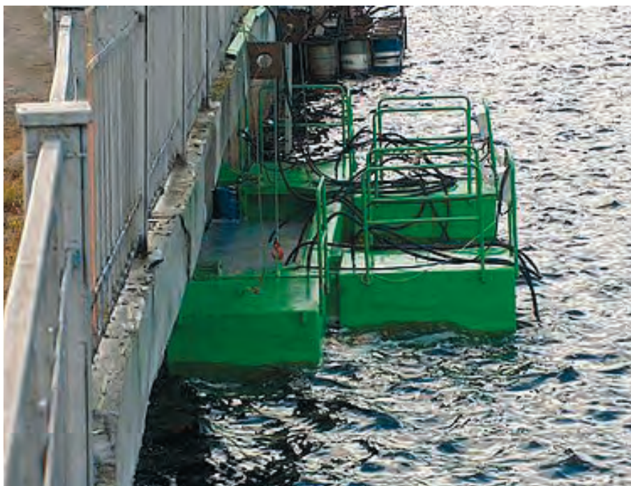
Рисунок 7.4.10 – Металлическая кессонная камера для ремонта структурно поврежденного бетона в зоне переменного уровня воды
